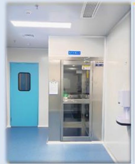
エアーシャワー室一 生産入口
